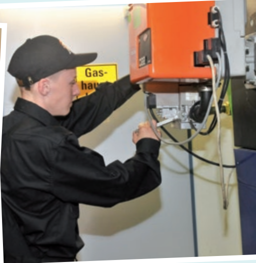
Service an einer Gasheizungsanlage
