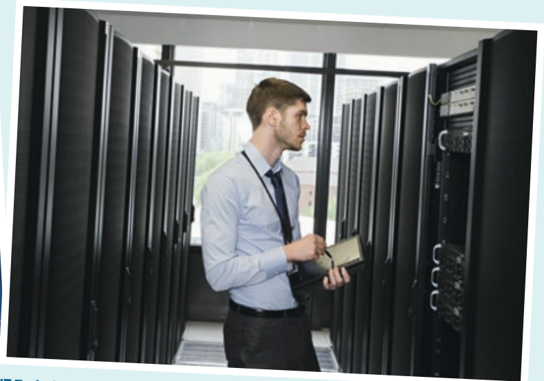
IT-Techniker kontrolliert im Serverraum
