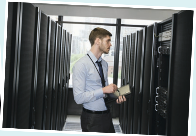
IT-Techniker kontrolliert im Serverraum
